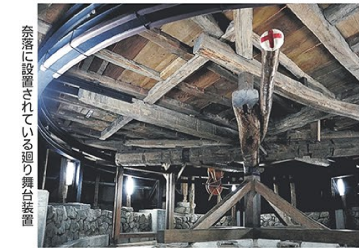
奈落に設置されている廻り舞台装置
